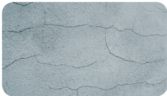
Nerespektováním uvedených zásad vzniká reálné riziko trhlin v omítkě
