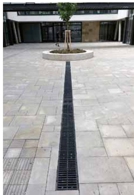
Odvodnění ploch Fakultní nemocnice v Olomouci je bezpečné (spádovaná varianta žlabů z polymerického betonu MEA EN 2000)
